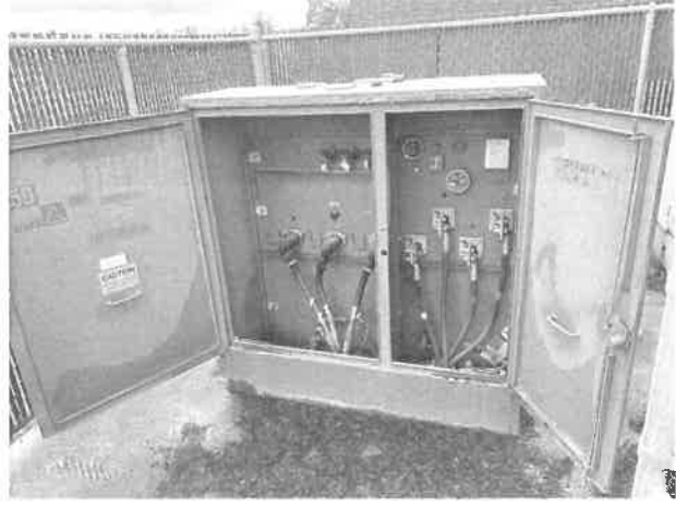
1 DRYDEN XFMR #16 INTERIOR - EXISTING N.T.S.
