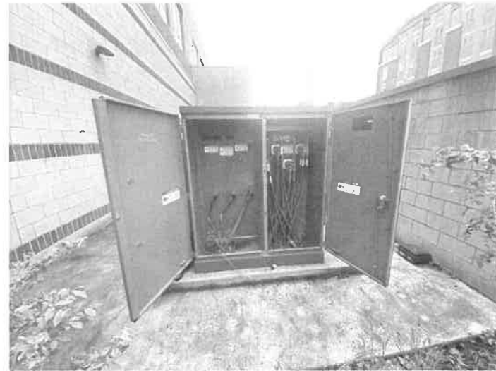
2 REC CENTER XFMR #54 INTERIOR - EXISTING N.T.S.
