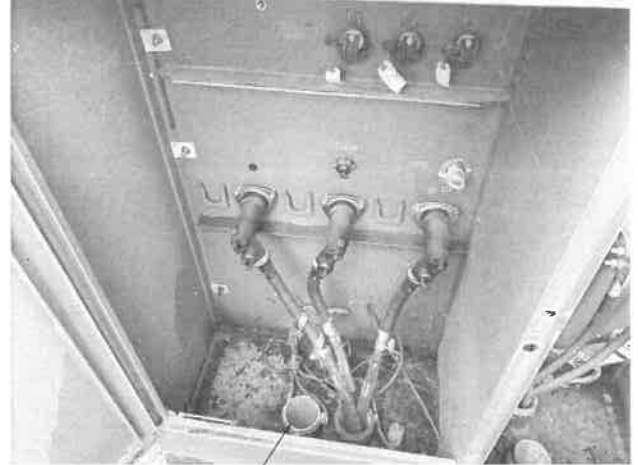
2 DRYDEN XFMR #16 INTERIOR - EXISTING N.T.S.
